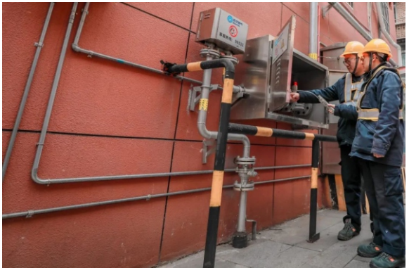
市燃气集团工作人员对鹦鹉巷子燃气管线进行巡查
